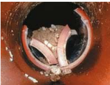
Kanalbruch vor Sanierung
